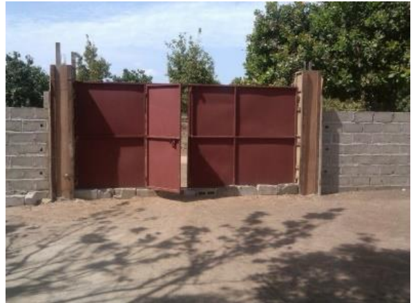
Nach der Rodung wurde mit dem Bau der Mauer mit dem imposanten Eingangstor begonnen.
